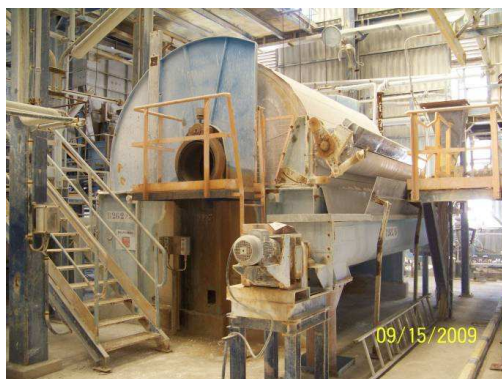
Filtros rotativos a vacío a sustituir
